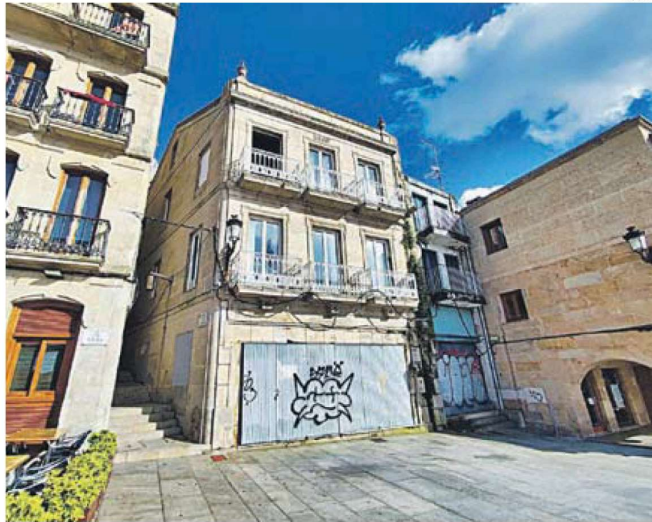
Dos edificios en los números 1 y 2 de la plaza del Berbés en reforma por iniciativa privada.
